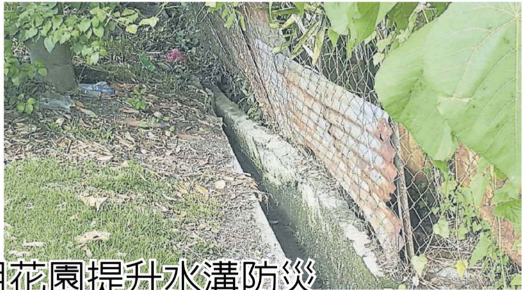
■士毛月花园50年前的排水沟已不能负荷现有排水量。
